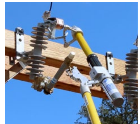
Figura 3 - Abriendo el cortacircuito
